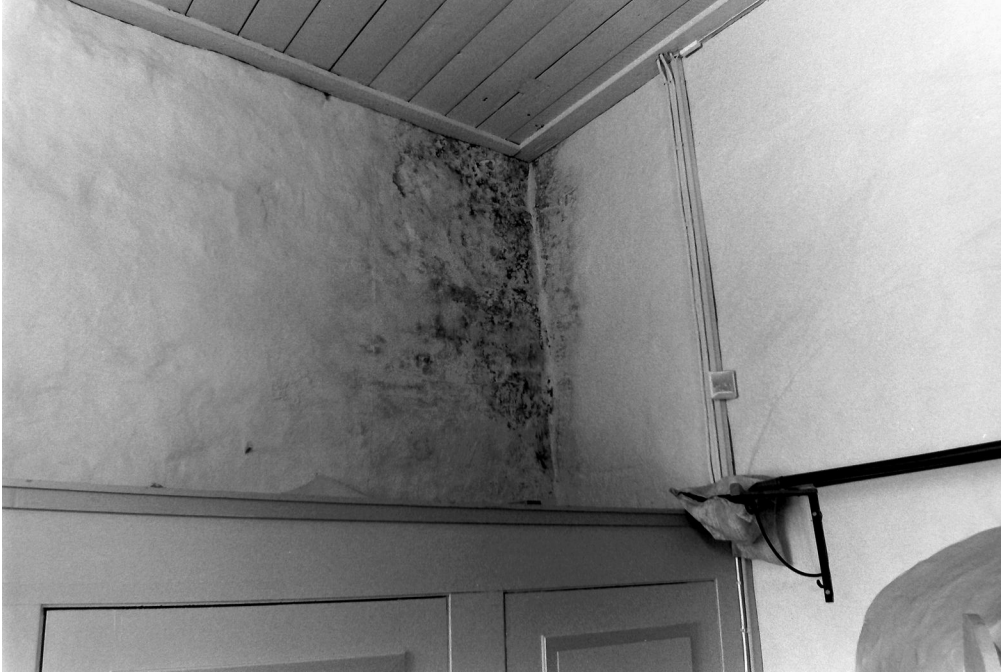
Bild 20. Skadan i sakristian vid nord-västra hörnet.
